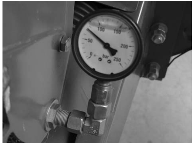
Imagen 9.14: Manómetro en la guía de cable por encima de la barra
