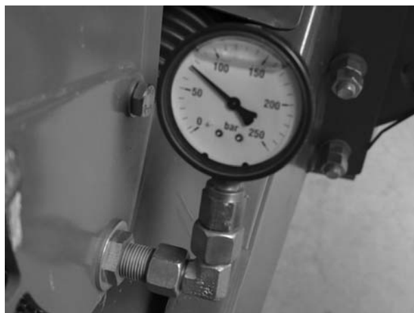
Imagine 9.14: Manometrul de pe traseul cablurilor de deasupra oiștei
