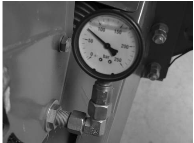
Bild 9.14: Manometer an Kabelführung über Deichsel
