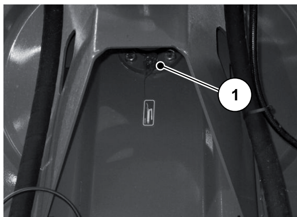
Imagine 10.39: Rulmentul cu flanșă al sistemului de acționare al suflantei
